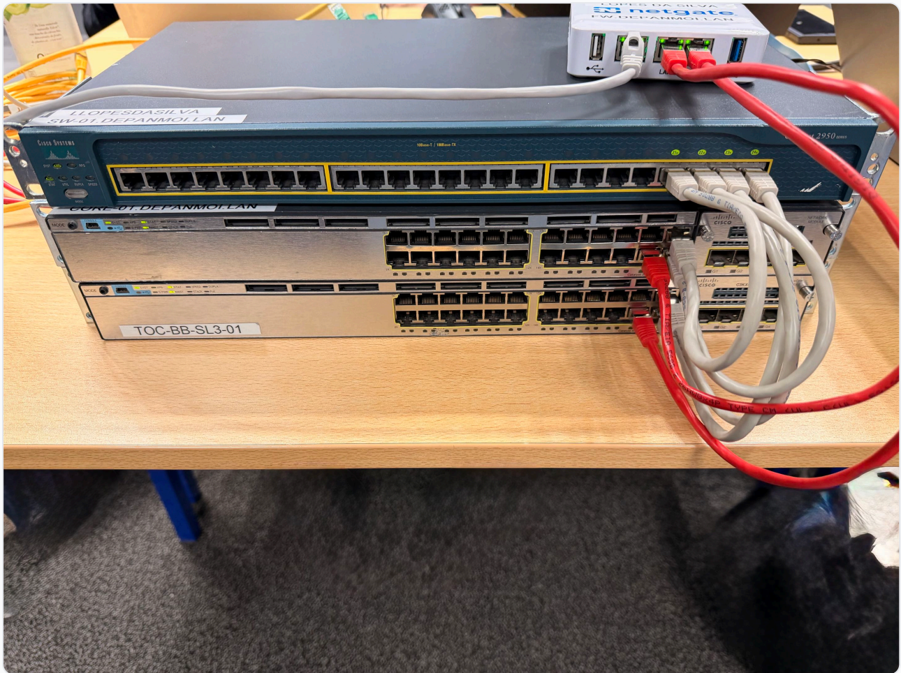
Figure 3.2 · Photo du rack technique déployé : SW-01, CORE-01, CORE-02, FW-01 et câblage réseau.
